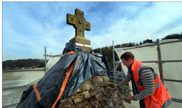
Le maçon Michael Dumont, au sommet du clocher détaché avec facilité la plupart des pierres sommitales de l'édifice très fragilisé. Photo Philippe JUSTE
